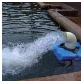
Bombas de volume.
